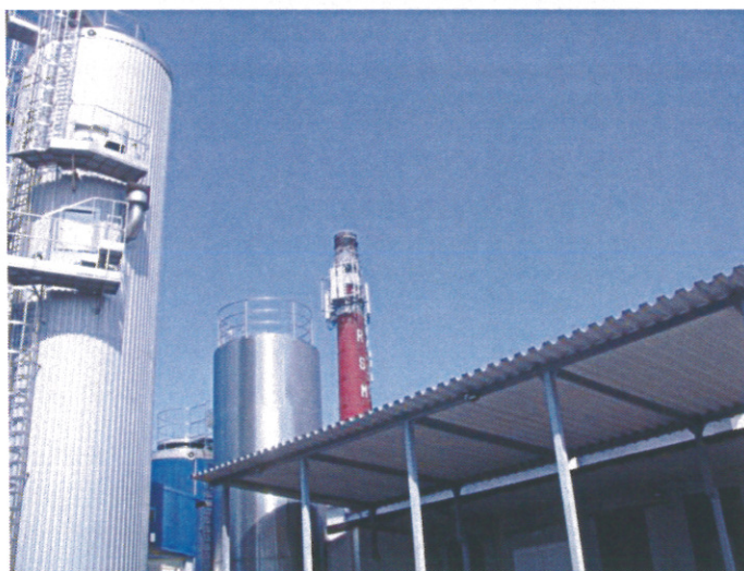
Zał. nr 1: Widok ogólny instalacji radiokomunikacyjnej.
