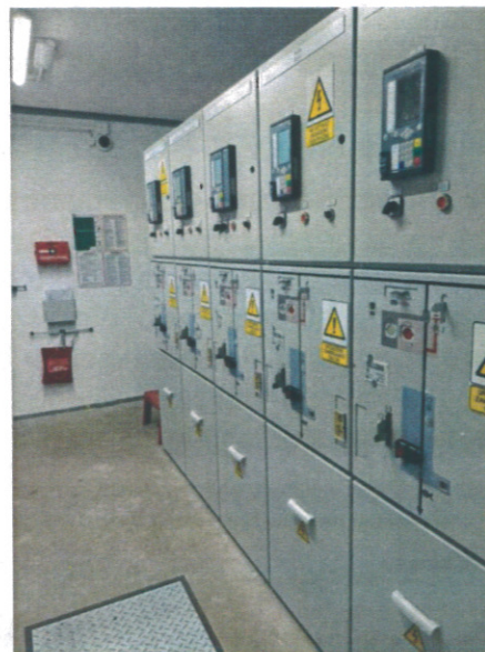
Rozdzielnia SN 30 kV
