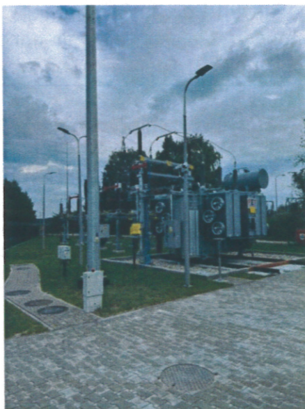
Rozdzielnia 30/110 kV GPO FW Gamów
